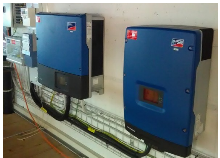
Die Wechselrichter wandeln unseren Solar-Gleichstrom in Wechselstrom um, der bis zu 85% direkt im Seewasserwerk verbraucht wird.
